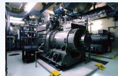
自家発電装置（海拔約24m） 自家発電に使用する燃料3日分
